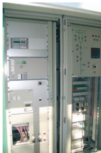
Nouvelles armoires du contrôle-commande New operation-control cupboards
