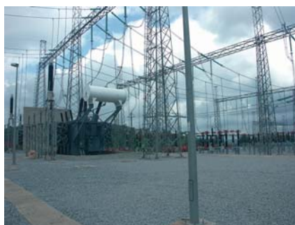
Poste électrique 330 kV existant avec place prévue pour ajout d'un autotransformateur de 150 MVA
