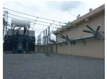
Extension d'un poste électrique prêt à recevoir un autotransformateur de 150 MVA
