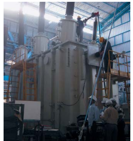
Autotransformateur de 150 MVA pour le nouveau poste de Ganmo et l'extension du poste de Ayede 150 MVA auto-transformer for the new Ganmo substation and the Ayede substation extension
