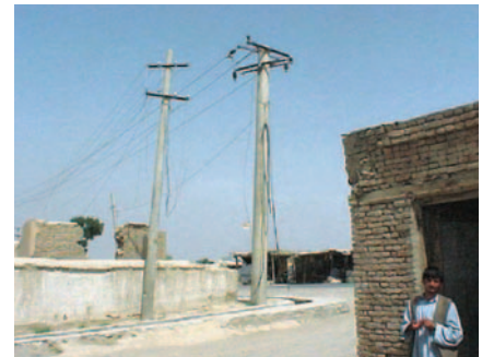
Etat du réseau 15 kV dans la région de Bagrami State of the 15 kV network in the Bagrami area
