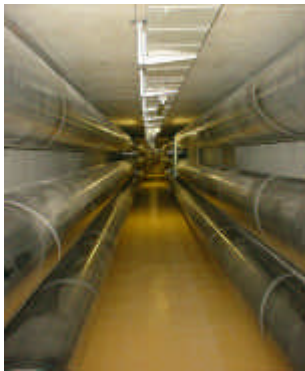
Ligne 220 kV souterraine - Genève
