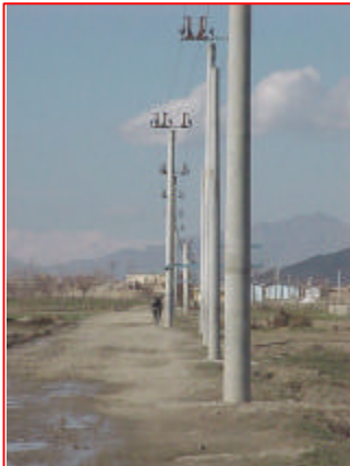
Pylones de Kaboul - Afghanistan
