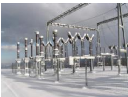
Centrale thermique de Chavalon - Suisse Poste de couplage 220 kV
