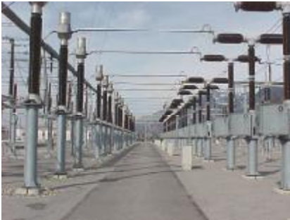
Poste 220 kV de St-Triphon - Suisse
