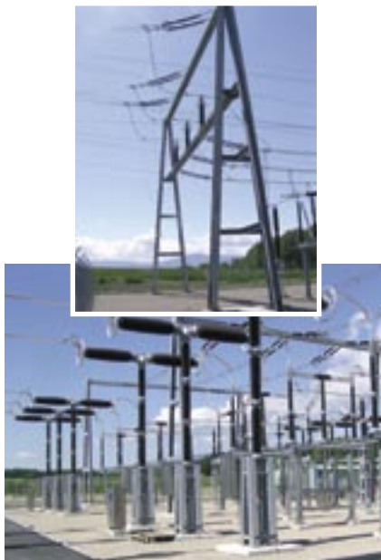
Poste 220 kV de Crans/Céligny, Suisse
