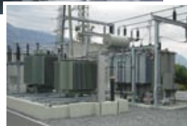
Poste 65 kV de Saint-Triphon, Suisse
