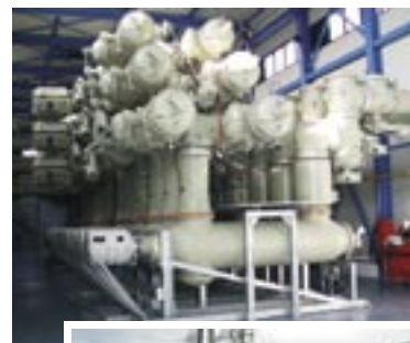
Poste de Chamson, installation de couplage 380 kV blindée, isolée au gaz SF6
