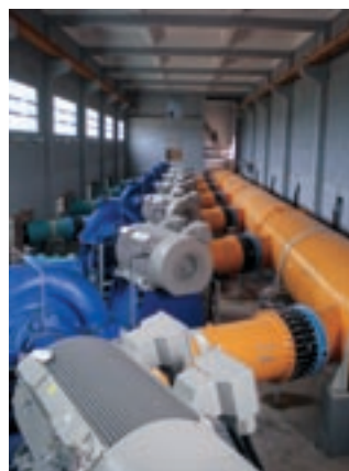
Station de pompage du transfert de Taksebt - Algérie
