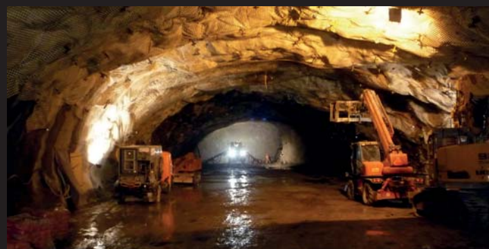
Caverne de la centrale de pompage-turbinage de Hongrin-Léman, Suisse
