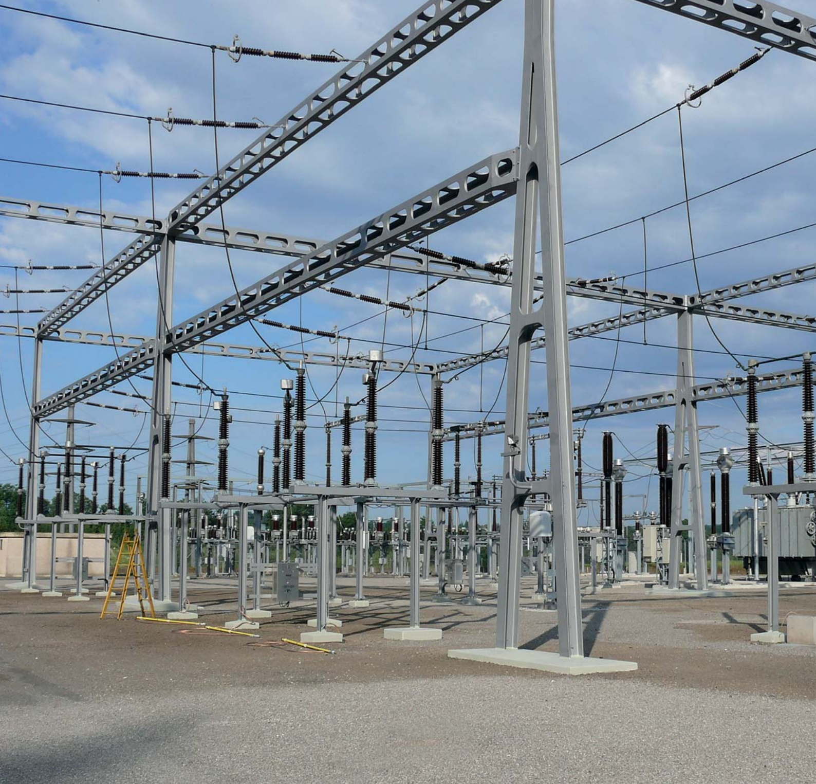
Poste électrique de Hauterive, Suisse
