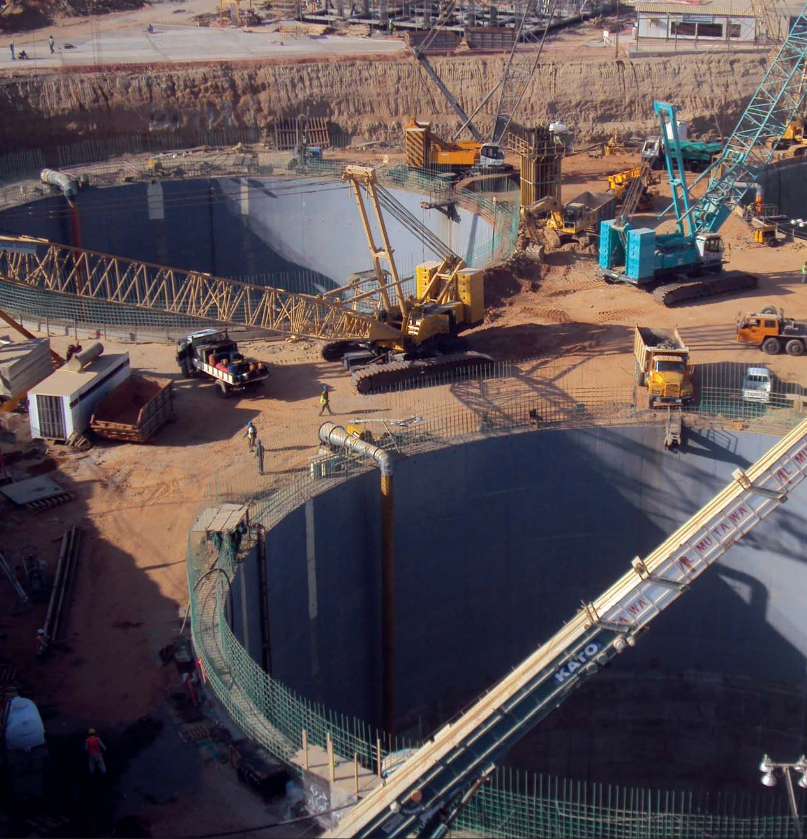
Puits de pompage des eaux usées à Djedda, Royaume d'Arabie Saoudite
