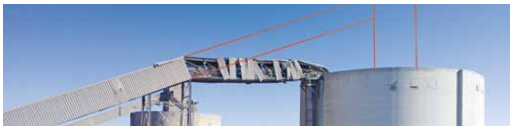
La toiture de 31 mètres de diamètre, le filtre qui la chapeautait et le pont de transport se sont effondrés dans le silo.
